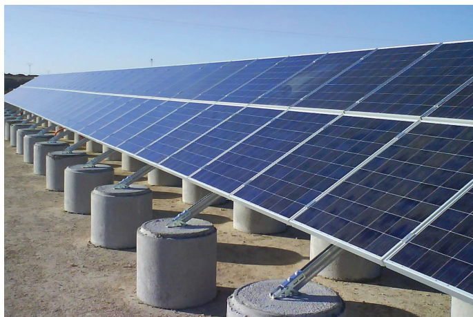
Rys. 59. Elektrownia fotowoltaiczna (źródło: wikipedia.org)
