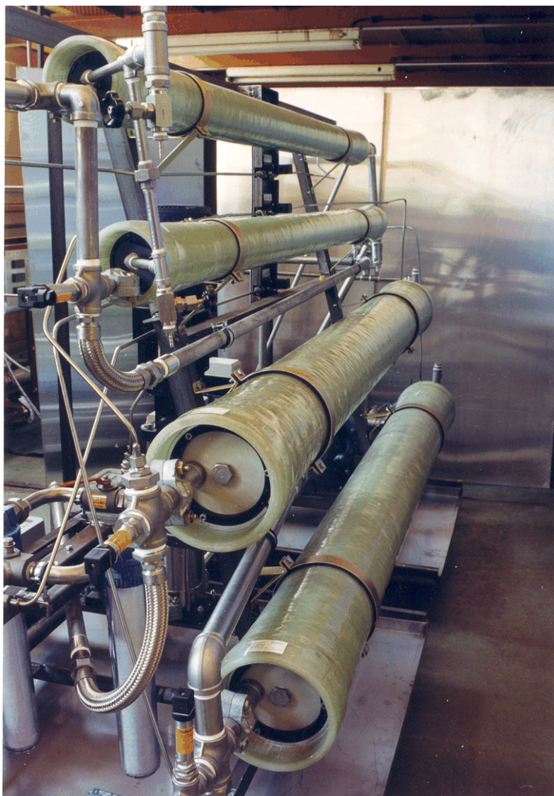
Rys. 5.5 Zestaw modułowy trzech jednostek membranowych używanych w Zakładzie Unieszkodliwiania Odpadów Promieniotwórczych w Świerku
